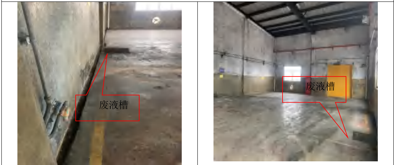
导流沟及废液槽
